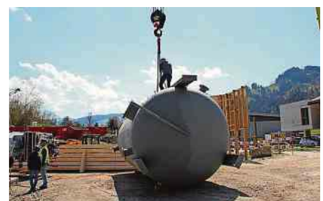
Der Wärmespeicher fasst rund 60 Kubikmeter Wasser.
