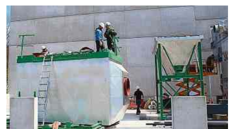
Der Elektrofilter liegt später auf dem rechts stehenden Trichter.
